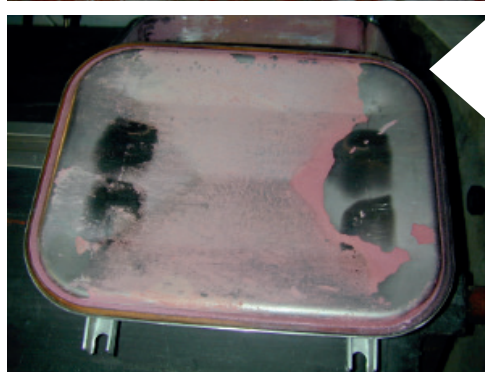
Photo 4 Encrassement par entartrage (P.Poupault)
